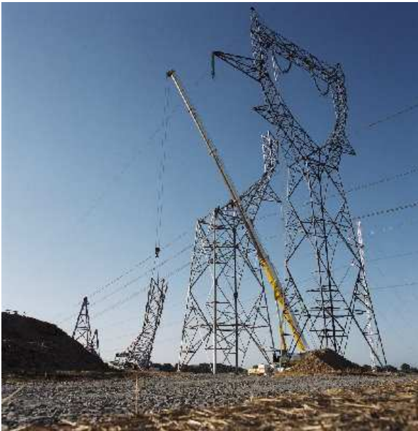
Travaux de sécurisation sur la ligne à 400 000 volts Domloup - Louisfert : mise en place de la partie centrale du pylône anti-cascade
